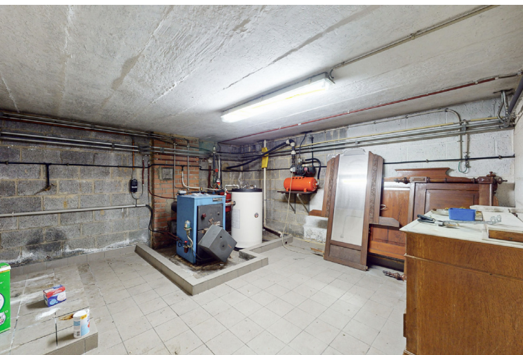
Sous-sol Local technique
